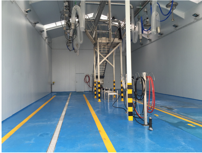
Líneas de lavado de cisternas alimentarias
