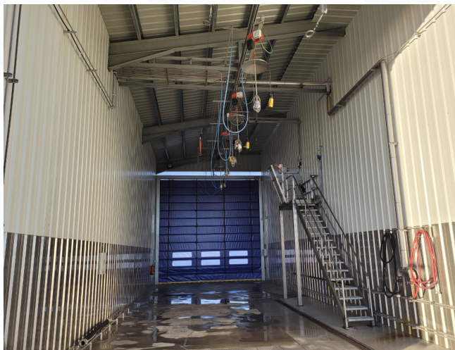
Línea de lavado con portón de acceso cerrado
